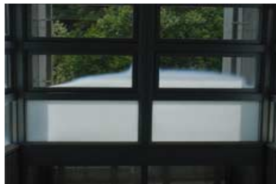
写真1 白濁ガラスが濁り始めたところ
