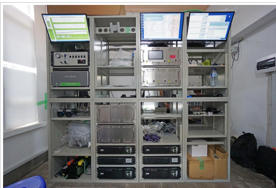
写真3 給水施設内に設置した観測システム機器の外観
