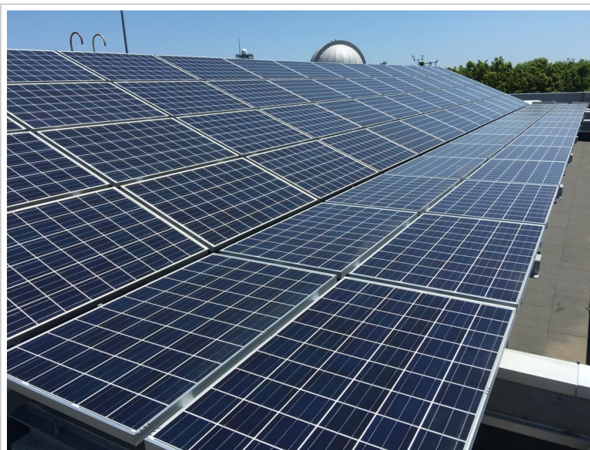
写真1 今回設置した太陽光パネル。モジュールの形が四角くなっています。以前のモジュールは円形でした
